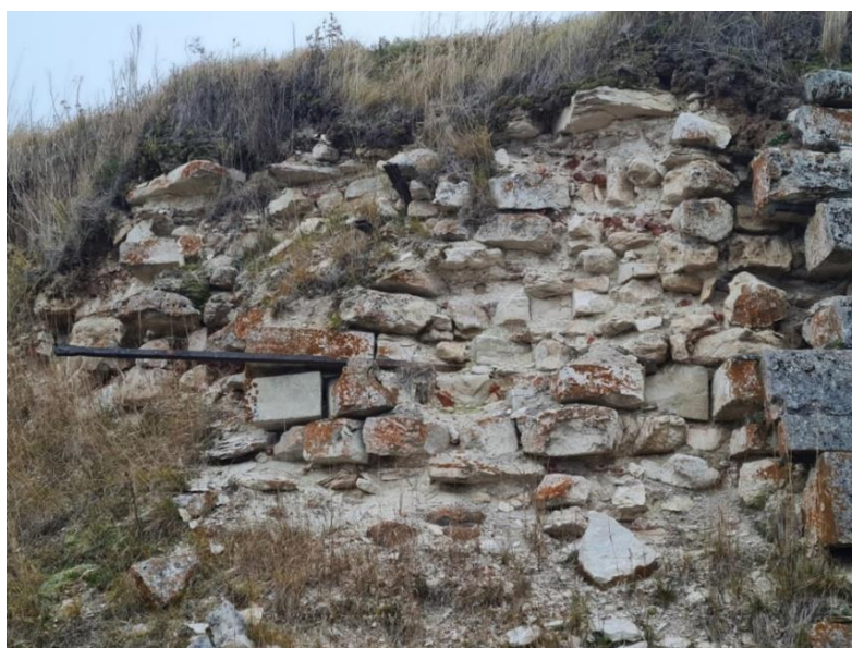
Рис. 1. Состояние известняковых кладок 06.11.2022 г.
