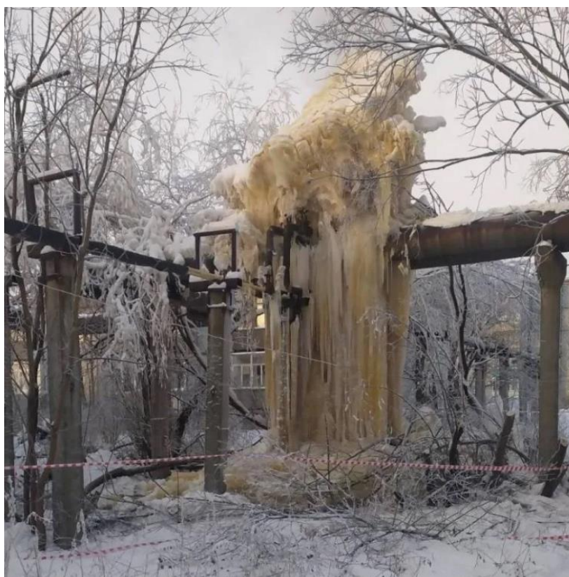
Рис. 1. Аварийная ситуация при теплоснабжении
